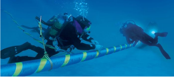
câble sous marin
